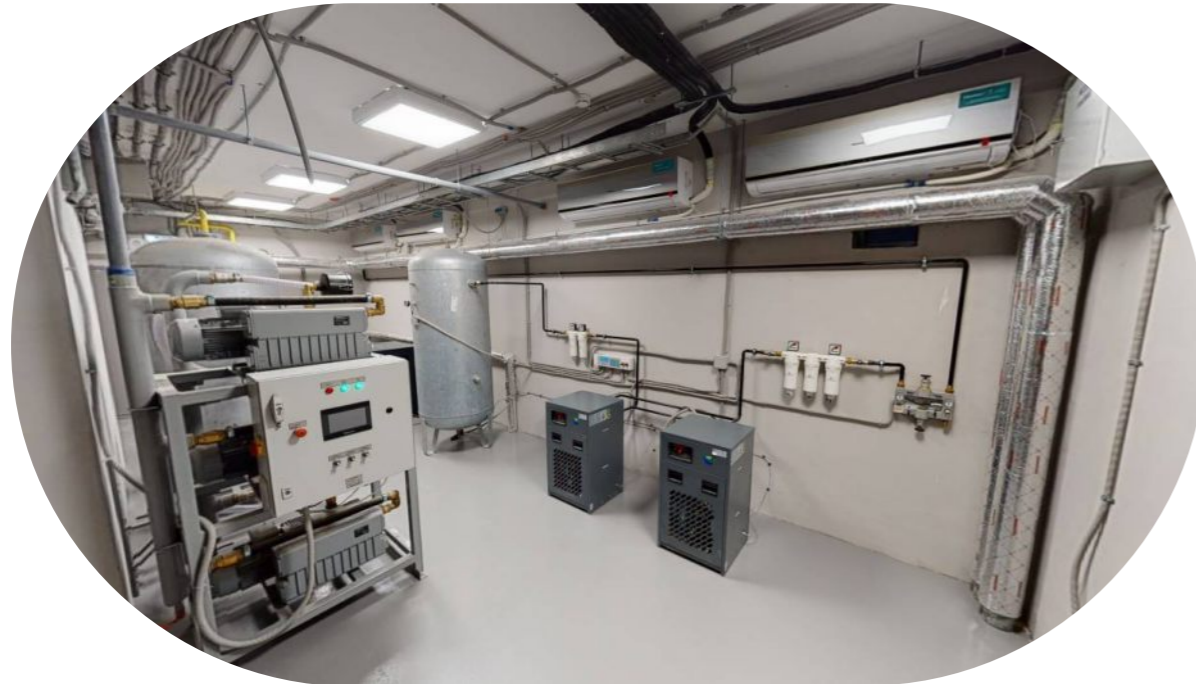
Поставка компрессорной газовой станции и станции центрального вакуума для ГБУЗ «ГКБ «им. С.З. Фишера»
